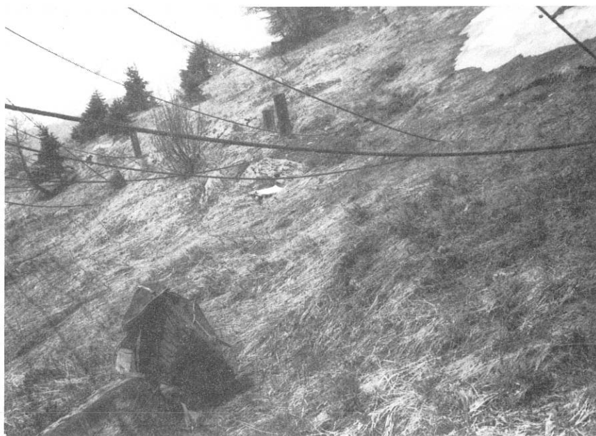
Fig. 13 - Tiranti a monte della rete paravalanghe superiore allentati, con gli ancoraggi in posizione inclinata e qualche cedimento del terreno. Margine dei prati di Stulles.
