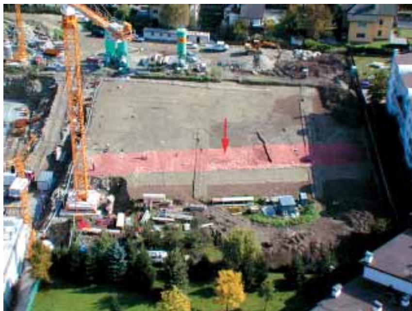
Fig. 21 - Cantiere «Wohnen am Park» a Rosslauf-Bressanone (veduta aerea da Sud). Rosslauf-Bressanone: corpo stradale con solchi carrai.
